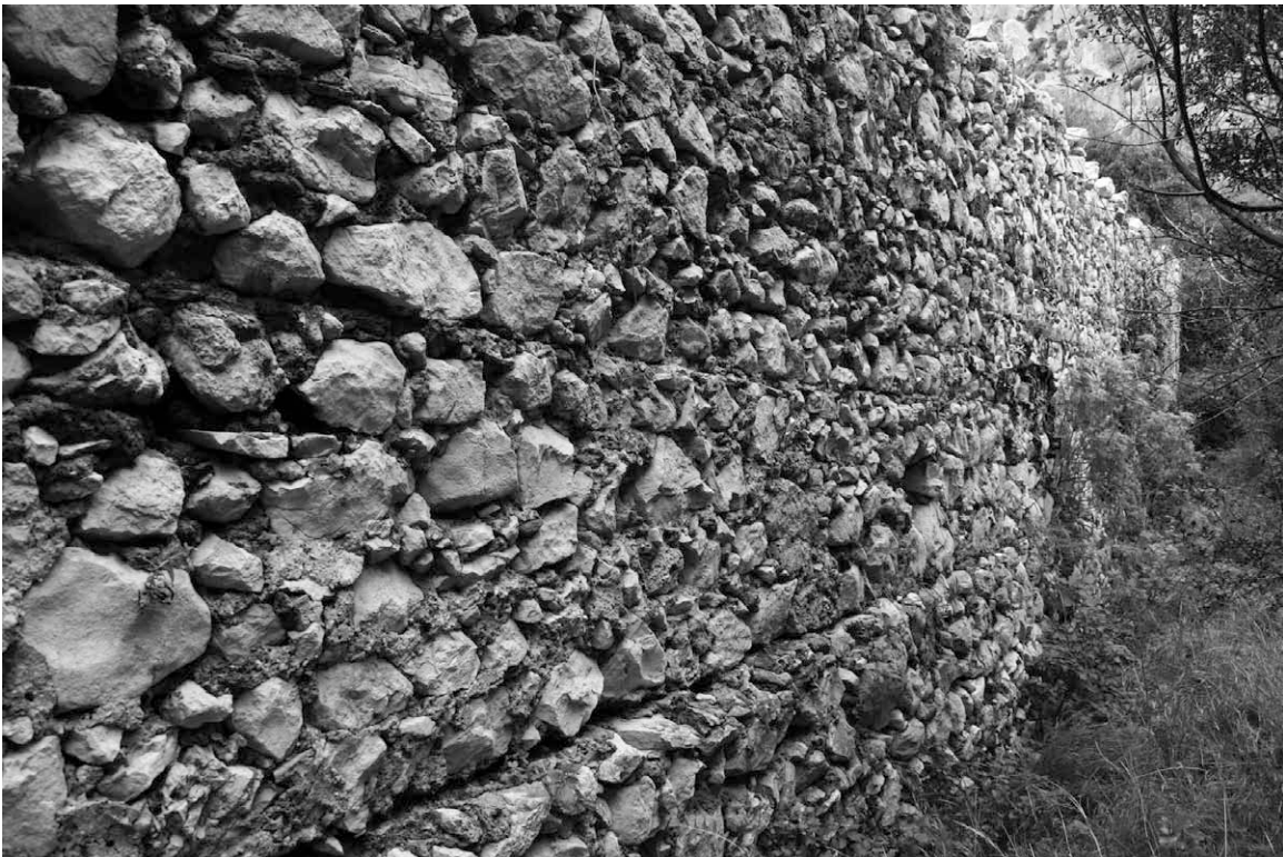
Fig. 82. Vista del paramento del muro dell'UT 06. Si noti la tecnica edilizia con bozze di calcare, apparecchiate su corsi suborizzontali, inzeppate con bozze di piccole dimensioni, schegge e laterizi, legate da una malta di calce abbondante. Si notano anche degli orizzontamenti approssimativamente ogni 80 cm.
