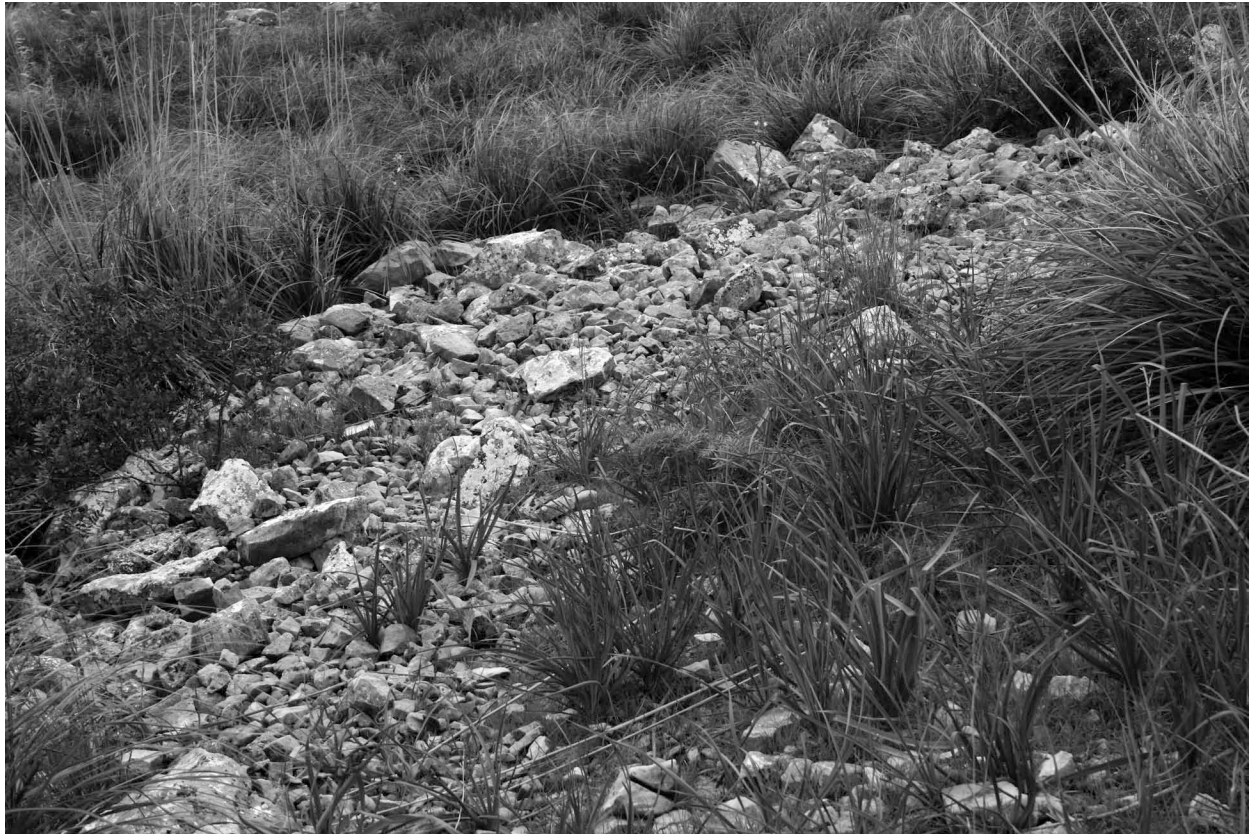
Fig. 98. Strutture murarie crollate sul fianco settentrionale di Pizzo Castellazzo.
