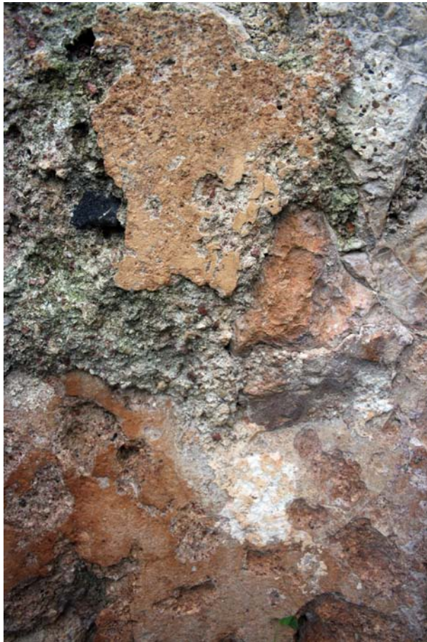
Fig. 80. Dettaglio degli strati di calce mescolata a cocciopesto che ricoprono la cisterna. Si notino anche le tracce di scalpellatura.
