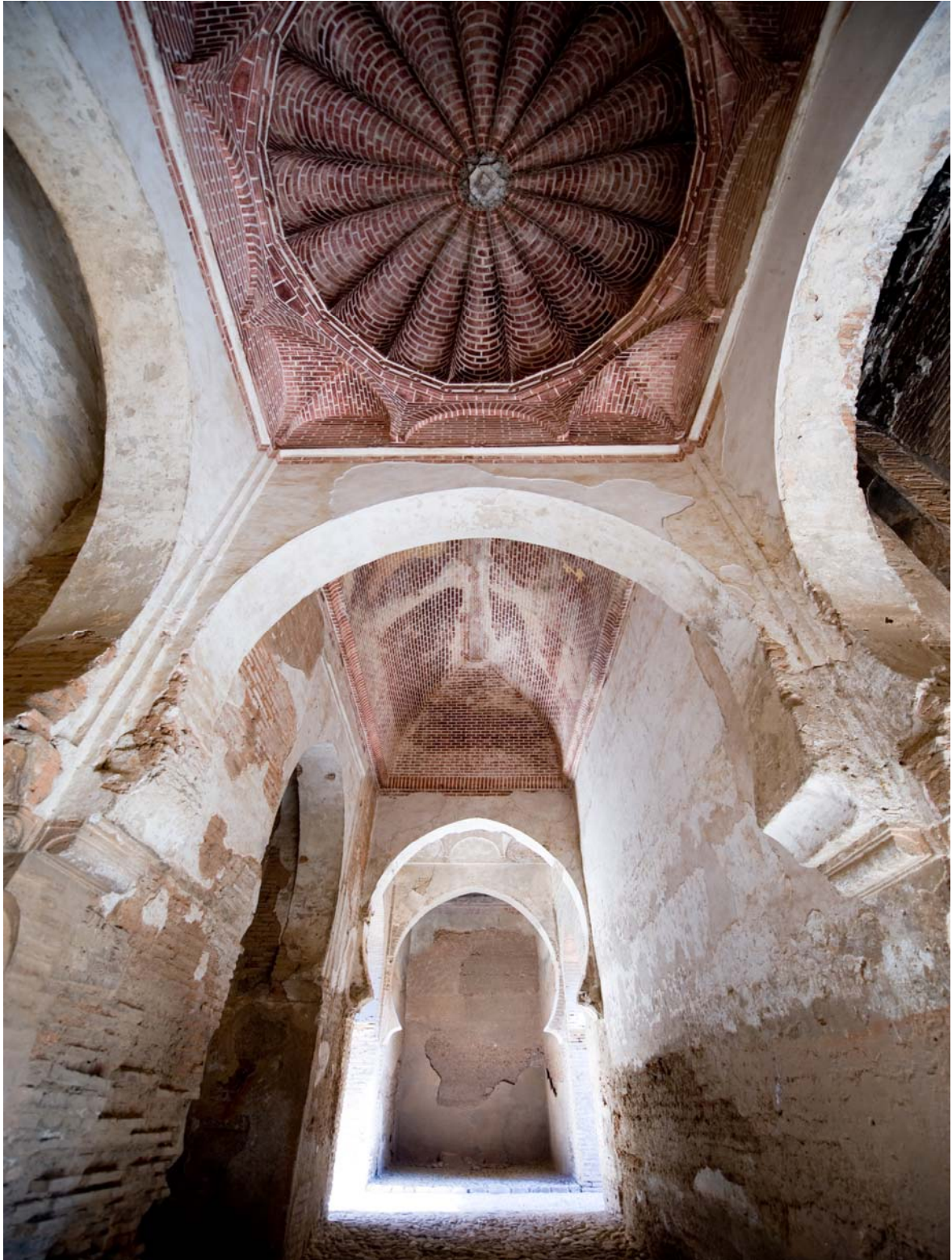
LÁMINA 4: INTERIOR DE LA PUERTA DE LAS ARMAS. BÓVEDAS DE MEDIA NARANJA Y VAÍDAS. FOTOS: FIESTAS MORENO, M.
