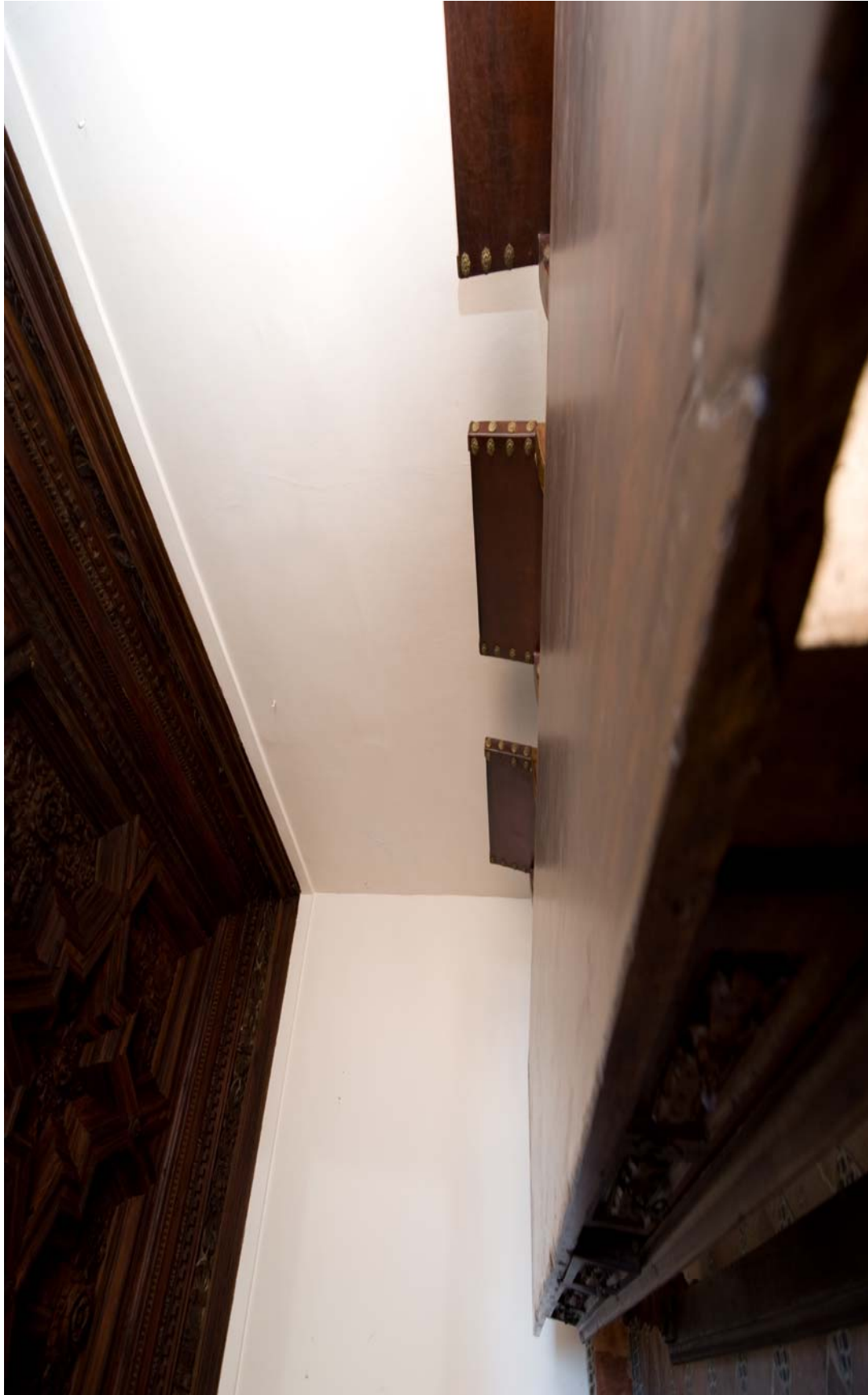
LÁMINA 101. DETALLE DEL MOBILIARIO Y ARTESONADO DE LA SEGUNDA SALA DE LAS HABITACIONES DE WASHINGTON IRVING. FOTOS: FIESTAS MORENO, M.
