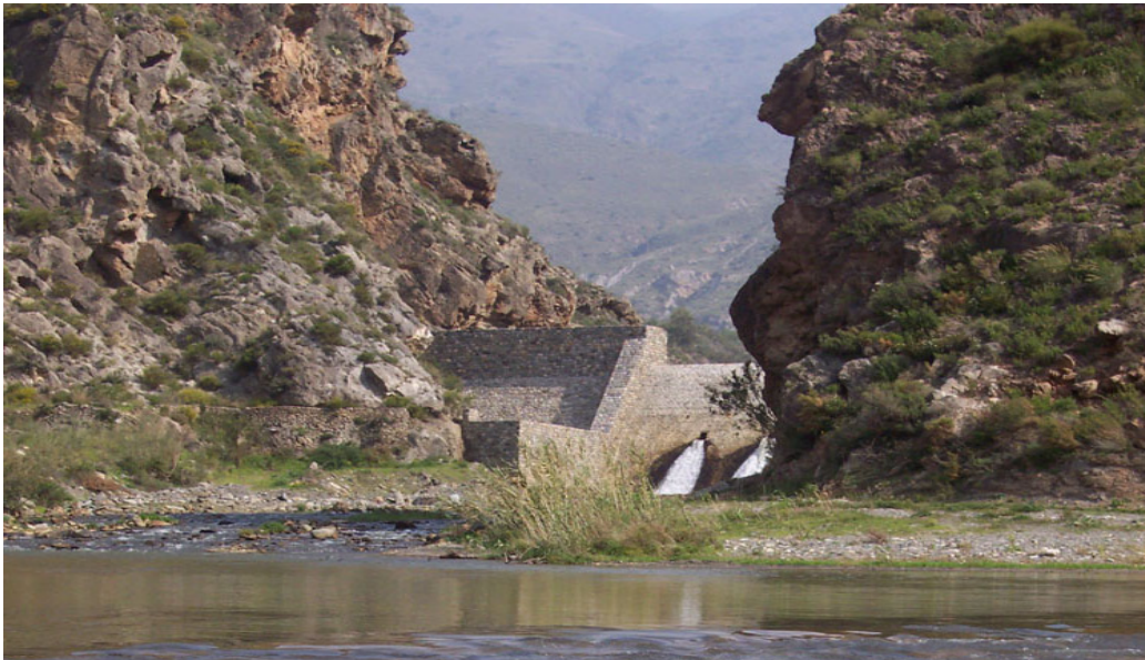
Figura 10. Presa de retención de sólidos en el Río Guadalfeo (Dique del Granadino)
