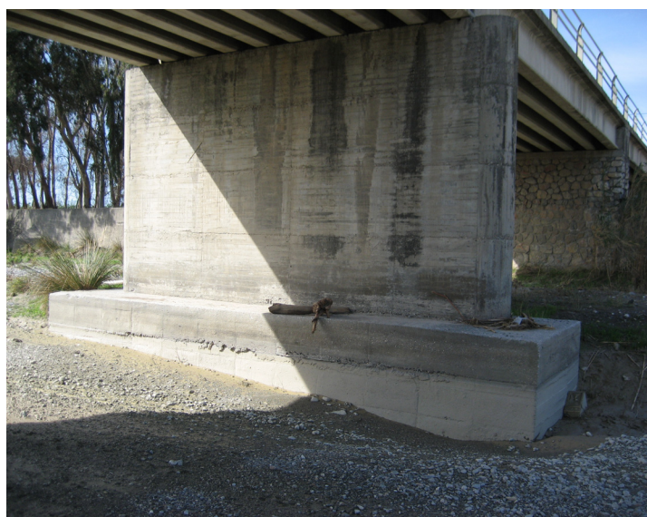
Figura 28. Erosión en la zona de pilas del viaducto de la N-340 sobre el río Guadalfeo
