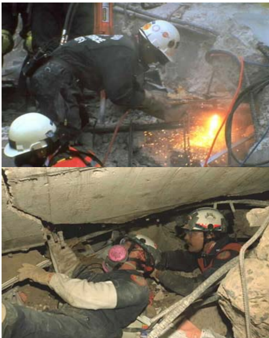
Figura 5.2. Labores de rescate. El acceso a las víctimas puede ser muy difícil, como se aprecia en estas imágenes.
