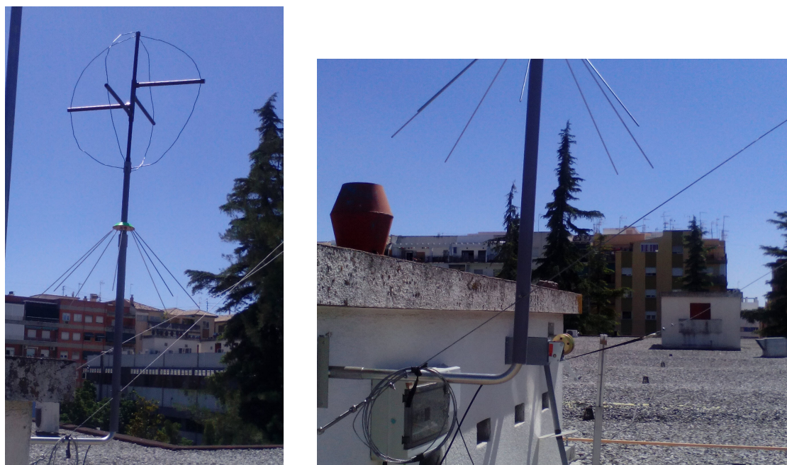
Figura 5.42 – Colocación de antena Eggbeater en la terraza de la Facultad de Ciencias de la Universidad de Granada.
