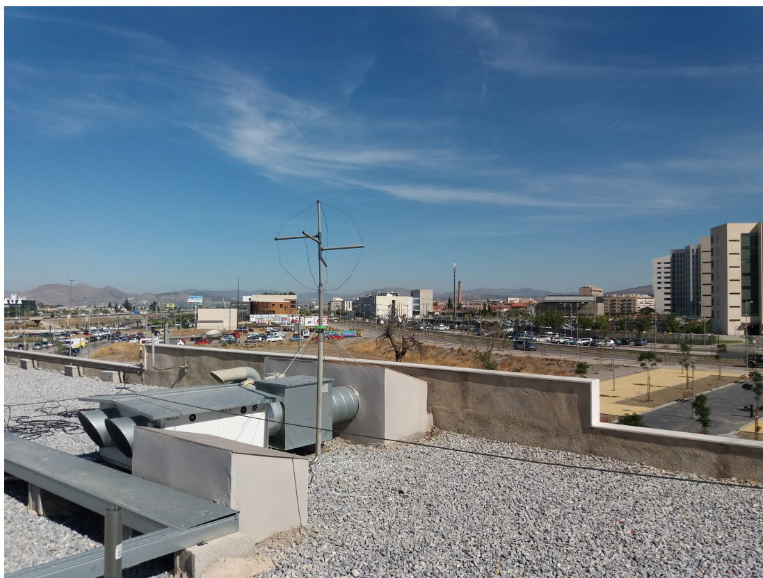
Figura 7.17 – Antena trasladada a edificio IMUDS.
