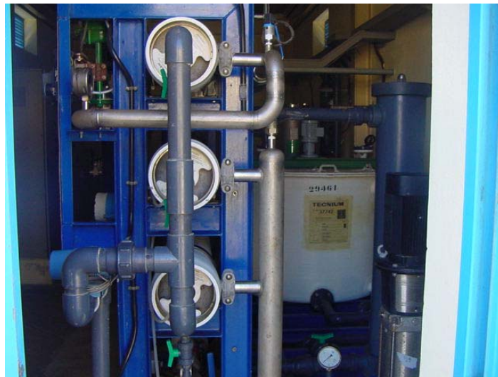
Figura 29. Vista de módulos de ósmosis inversa
