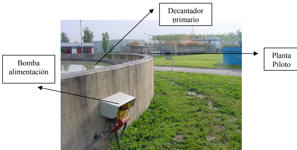
Figura 41. Bomba de alimentación planta piloto
